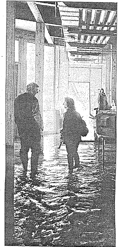
Bis zu 30 Zentimeter hoch steht das Wasser.
